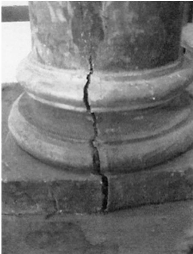
Grietas en estructura por cambios de humedad
