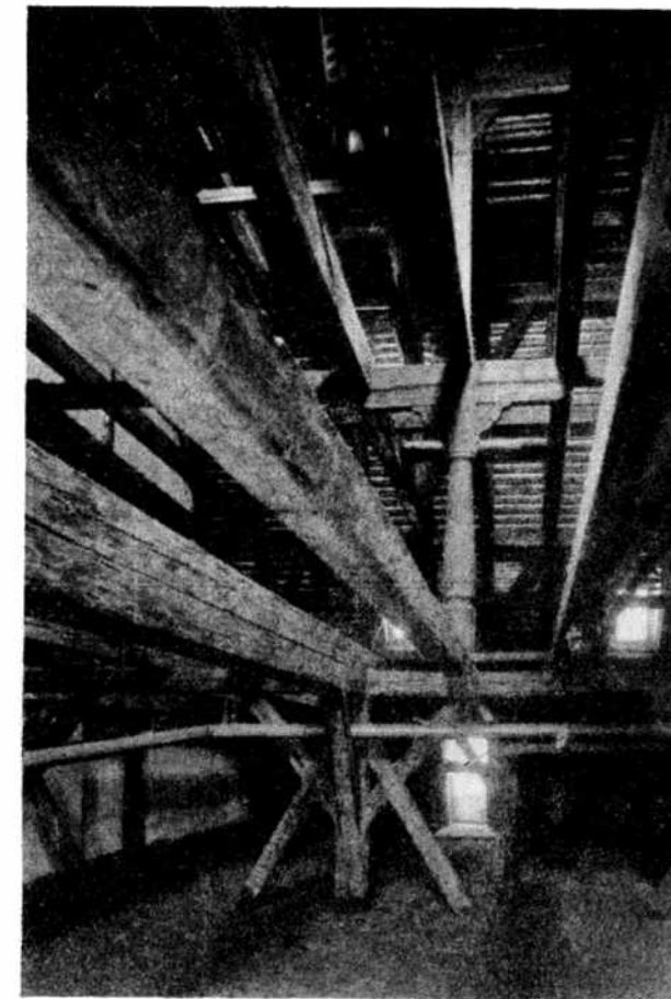
Fig. 1. Spécimen de comble de structure complexe. (Phot. prise par Č. Šfla)
