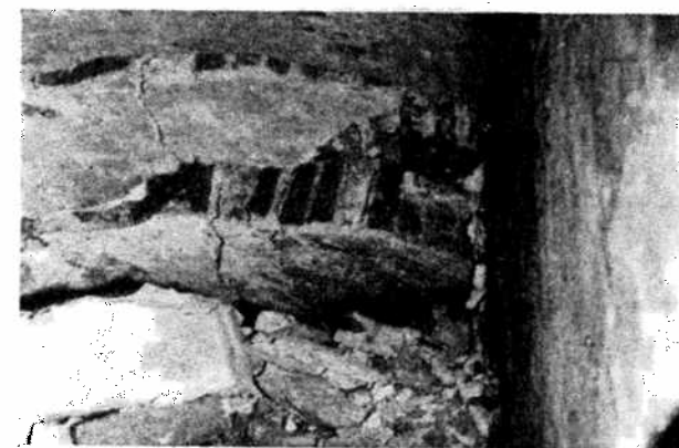
Fig. 4a. Photographie des voûtes effondrées du couloir transversal; à une hauteur de 0,8 m au-dessus de ces voûtes étaient posés des rails sur lesquels des tramways circulaient pendant plusieurs dizaines d'années
